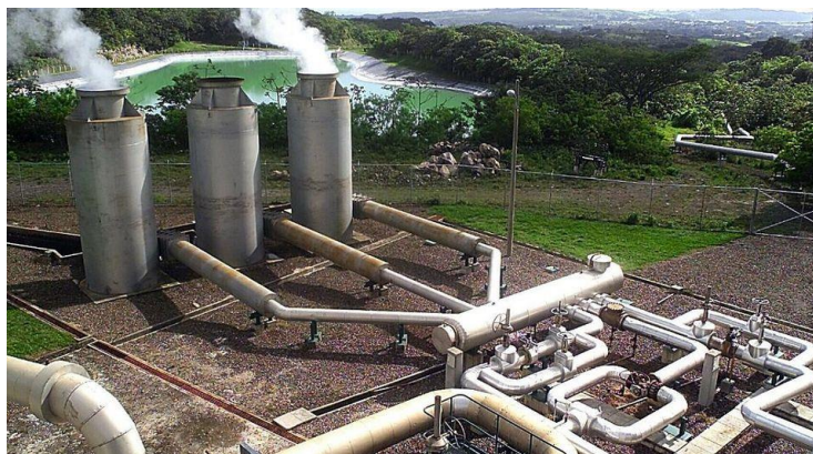
Imagen 18. Planta Geotérmica Miravalles I
