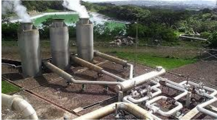
Imagen 5. Planta Geotérmica Miravalles, ubicada en la provincia de Guanacaste
